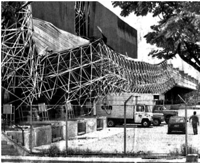
Figura 10 - Colapso da cobertura metálica do estacionamento do aeroporto de Cumbica em Guarulhos / São Paulo
